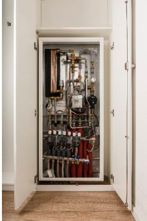
(11_AEG_Hertie-Umbau Lünen_Wohnungstation geschlossen.jpg)
