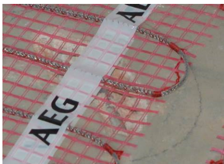
11a AEG Badrenovierung Bodenfühler.jpg
