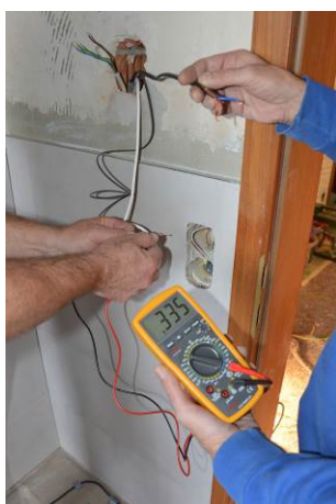
12 AEG Badrenovierung E-Anschluss.jpg
