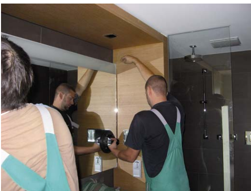
BU: Installation der Spiegel inklusive vormontierter AEG Spiegelheizung im Hotelbad durch das Glaszentrum Wissmar
