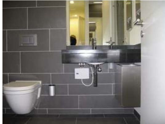
BU: AEG Kleindurchlauferhitzer in den WC Anlagen des KANHAUSplus, Köln
