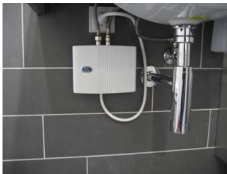
BU: AEG Kleindurchlauferhitzer MTH sorgt für eine dezentrale, energiesparende Warmwasserversorgung in den 80 WC-Anlagen im KANHAUSplus, Köln
