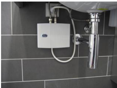
BU: AEG Kleindurchlauferhitzer MTH sorgt für eine dezentrale, energiesparende Warmwasserversorgung in den 80 WC-Anlagen im Kranhaus Süd, Köln
