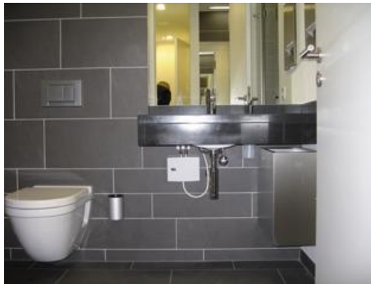
BU: AEG Kleindurchlauferhitzer in den WC-Anlagen des Kranhaus Süd, Köln
